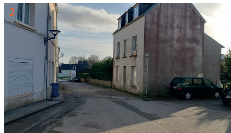
Rue du Puits, faible largeur de trottoir voire absence totale. Revêtement de voirie dégradé.
